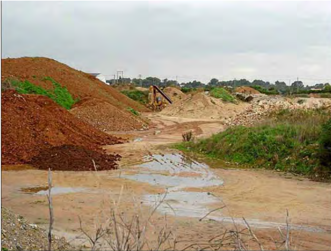
Primeros movimientos de tierra en los terrenos de Son Bosc de Muro. / PEP VICENS
